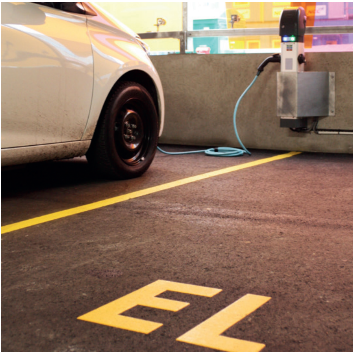
BILD 8. Destinationsladdare i parkeringsgarage utrustad med påkörningsskydd. Foto: Region Uppsala län
