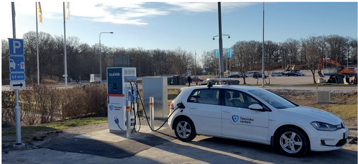
BILD 3. Snabbladdare Ingelsta, Norrköping med tydlig skyltning och påkörningsskydd. Foto: Uppladdning.nu
